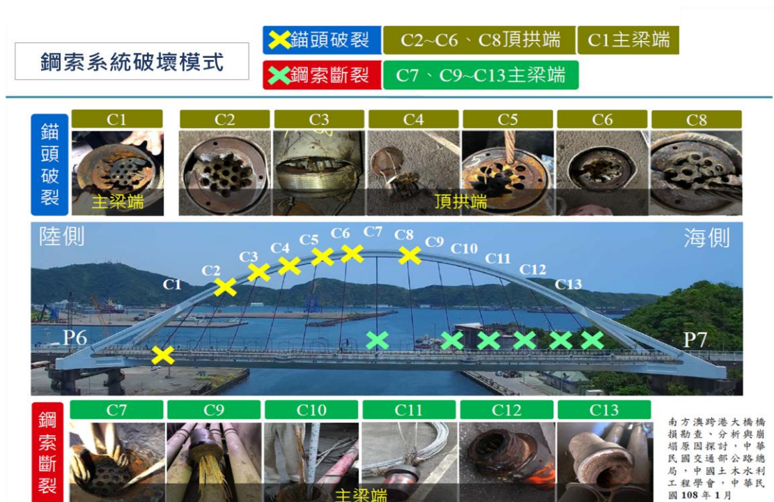
南方澳大橋吊索系統破壞模式(參考自中國土木水利工程學會資料)
